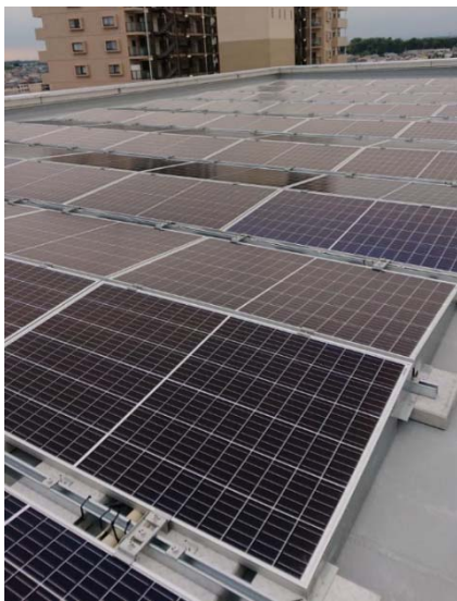
研究本館屋上設置太陽光パネル
