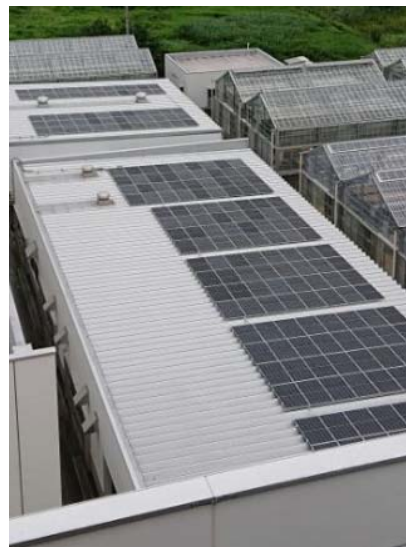
栽培管理棟屋上設置太陽光パネル
