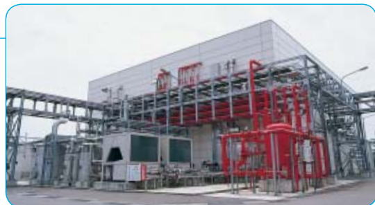
富山工場 ARCプラント
